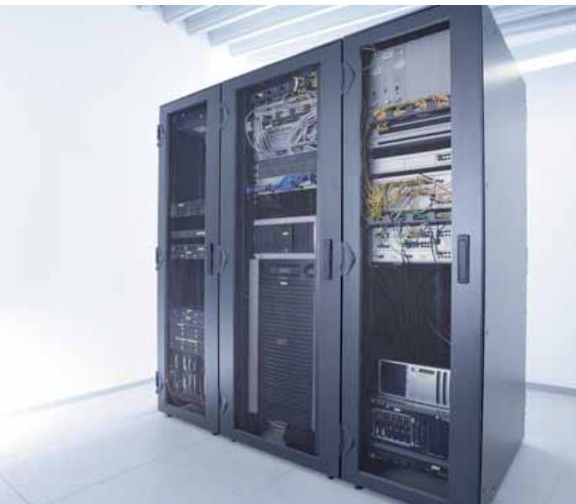
Technik kann auch schön sein – der Serverschrank verbindet edles Design und Funktion zu einem interessanten Objekt.
